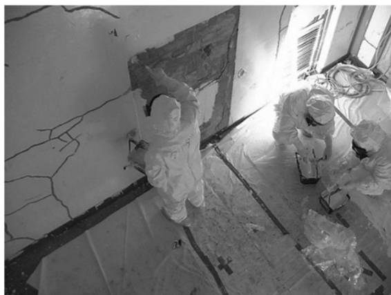
145号室の汚染固定
